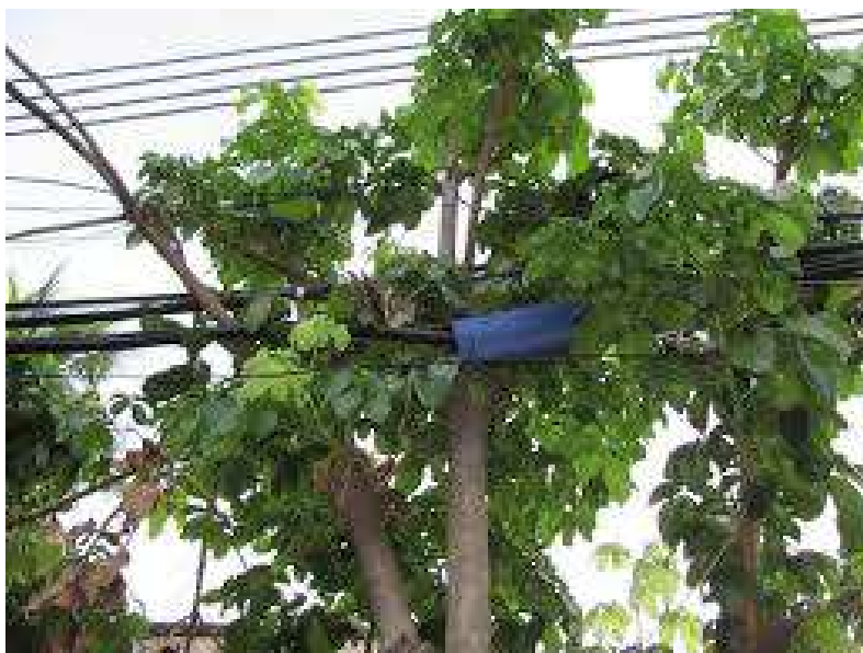
Figura 10: Exemplo de árvore sem poda em meio a rede de fios elétricos
