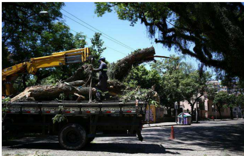
Figura 9: Exemplo de servidores fazendo a poda de árvores perto de rede elétrica.
