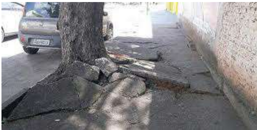
Figura 6: Exemplo de uma árvore que rompeu com o solo, devido a espécie não ser adequada para o local.
