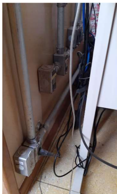
Imagem 84 - Tomadas baixas localizadas no acesso a sala de pedagogia estão a 16 e 30cm do piso e possui altura menor do que a mínima recomendada pela norma.
