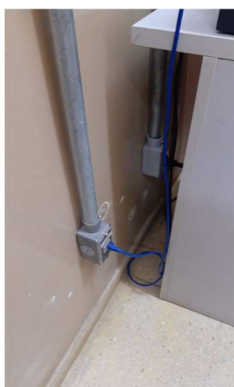
Imagem 83 - Tomadas baixas localizadas na sala de acesso aos departamentos estão a 30cm do piso e possui altura menor do que a mínima recomendada pela norma.
