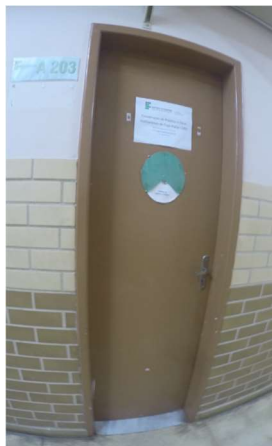
Imagem 33 - Porta Sala A-203 sem sinalização em relevo.
