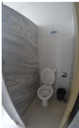
Imagem 64 - Porta do boxe sanitário masculino pavimento térreo abre para dentro sem ter um raio mínimo de circulação dentro dos boxes.
