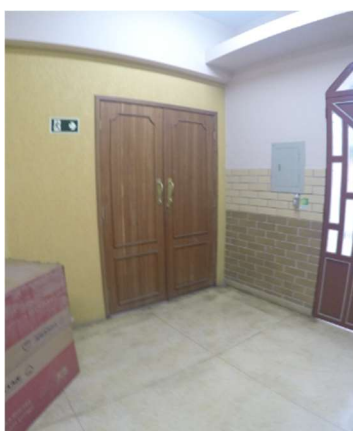
Imagem 38 - Acesso ao auditório sem sinalização tátil, não possui placa de identificação em relevo, puxador mais alto do que o mínimo permitido.
