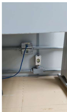
Imagem 91 – Tomadas RJ45 localizadas na sala A-207 estão a 25 e 30cm do piso e possui altura menor do que a mínima recomendada pela norma.
