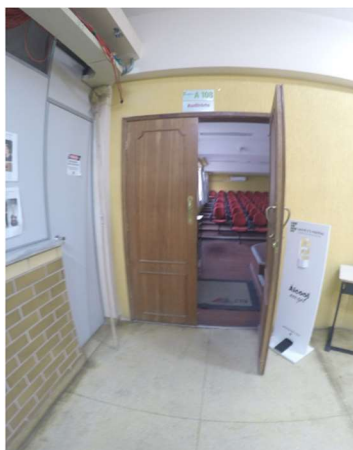
Imagem 37 – Acesso ao auditório sem sinalização tátil, não possui placa de identificação em relevo, puxador mais alto do que o mínimo permitido.
