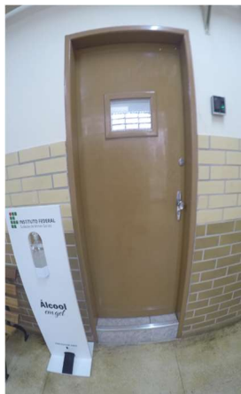
Imagem 68 - Porta da sala de Telemática A – 101 não possui sinalização em relevo, não possui maçaneta do tipo alavanca, ambiente possui desnível de 15cm.
