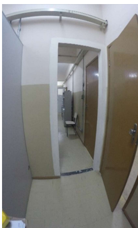
Imagem 15 – Circulação da Sala A-207 não possui espaço para manobra de cadeira de rodas.
