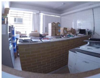
Imagem 36 – Balcão de atendimento Sala A-202 - com altura maior do que estabelecido pela norma para superfícies acessíveis, ambiente não possui espaço para manobra de P.C.R.
