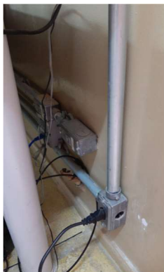
Imagem 81 - Tomadas baixas localizadas na sala de acesso aos departamentos estão a 20, e 35cm do piso e possui altura menor do que a mínima recomendada pela norma.
