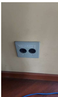
Imagem 86 - Tomadas baixa localizadas no palco do auditório estão a 30cm do piso e possui altura menor do que a mínima recomendada pela norma
