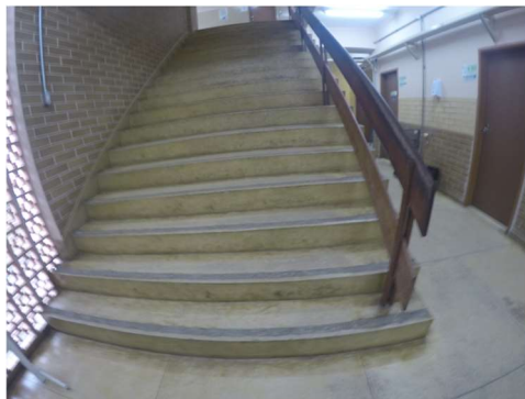
Imagem 3 – Escada bloco A de acesso ao 1º pavimento não possui piso de alerta.
