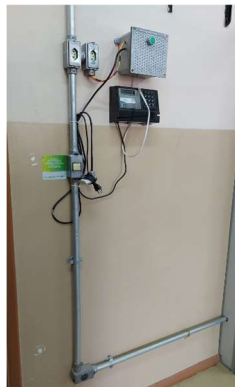
Imagem 90 - Interruptores localizados na sala A-207 estão a 130cm do piso e possui altura maior do que a máxima recomendada pela norma, da mesma maneira as tomadas altas estão a 170cm do piso e a baixa a 30cm também não atendem as recomendações da norma.
