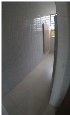
Imagem 63 - Acesso a Sanitário acessível Masculino no pavimento térreo não possui espaço para manobra de P.C.R.
