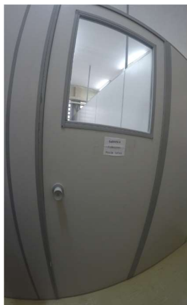
Imagem 21 – Porta Gabinete 04 localizada na sala A-207 sem sinalização em relevo e não possui maçaneta do tipo alavanca.
