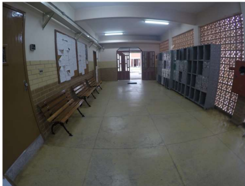
Imagem 2 - Acesso ao bloco A não possui sinalização.
