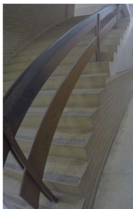
Imagem 4 – Escada bloco A não possui guia de balizamento e sinalização de degraus.
