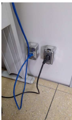
Imagem 82 - Tomadas baixas localizadas na sala de acesso aos departamentos estão a 25cm do piso e possui altura menor do que a mínima recomendada pela norma.
