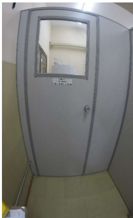
Imagem 14 – Porta Gabinete 01 - Localizada na sala A-207 não possui sinalização em relevo e não possui maçaneta do tipo alavanca.
