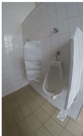
Imagem 40 - Mictório em sanitário Masculino coletivo térreo não está de acordo com a norma.
