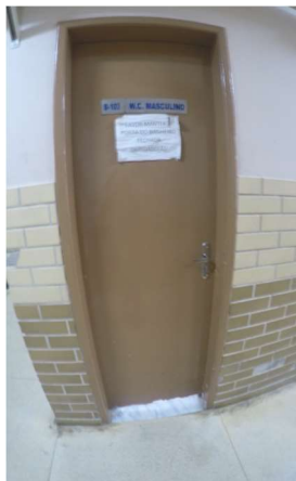
Imagem 38 - Porta Sanitário masculino térreo sem sinalização em relevo, não possui maçaneta do tipo alavanca, vão da porta menor do que estabelecido pela norma.
