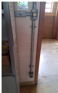
Imagem 64 - Tomadas baixas localizadas na sala de Tecnologia da informação do pavimento térreo estão a 20cm do piso, e possuem altura menor do que a mínima recomendada pela norma, da mesma maneira o interruptor e comando do ventilador localizados no ambiente possuem altura 110cm do piso também não atendendo as recomendações da NBR.
