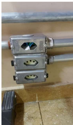
Imagem 58 - Tomadas baixas localizadas no laboratório de informática I do pavimento térreo estão a 12, 18 e a 23cm do piso, e possuem altura menor do que a mínima recomendada pela norma.
