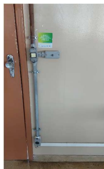
Imagem 60 - Tomadas baixas localizadas na sala B 106 do pavimento térreo estão a 20cm do piso, e possuem altura menor do que a mínima recomendada pela norma, da mesma maneira o interruptor e comando do ventilador localizados no ambiente possui altura de 110cm do piso também não atendendo as recomendações da NBR.
