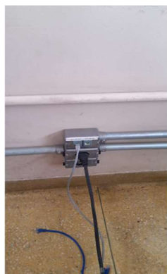
Imagem 66 – Tomadas na sala de Despertamento de Gestão de TI no pavimento térreo, estão a 25,30 e 35cm do piso e possuem altura menor do que a mínima recomendada pela norma.
