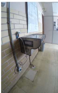
Imagem 7 – Bebedouro 2º pavimento do bloco B apenas com uma altura e sem sinalização tátil de alerta.
