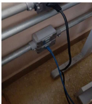
Imagem 65 - Tomadas baixas localizadas na sala de tecnologia da informação do pavimento térreo estão a 25 e 30cm do piso e possuem altura menor do que a mínima recomendada pela norma.
