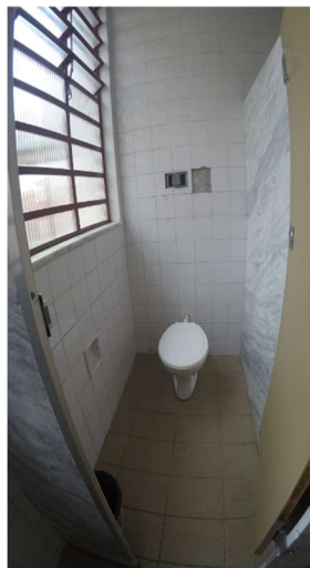
Imagem 37 - Porta do boxe em sanitário feminino 1º pavimento abre para dentro sem ter um raio mínimo de circulação dentro dos boxes.
