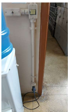
Imagem 67 - Tomadas baixas localizadas na sala de Departamento de gestão de TI do pavimento térreo estão a 25cm do piso, e possuem altura menor do que a mínima recomendada pela norma, da mesma maneira o interruptor e comando do ventilador localizados no ambiente possuem altura 105cm do piso também não atendendo as recomendações da NBR.
