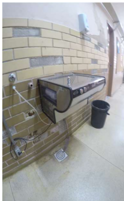
Imagem 6 - Bebedouro do térreo do bloco B apenas com uma altura e sem sinalização tátil de alerta.
