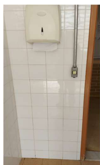
Imagem 68 – Interruptor localizado no sanitário masculino do pavimento térreo está a 110cm do piso e possui altura maior do que a máxima recomendada pela norma.
