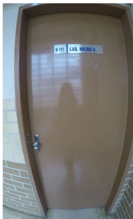
Imagem 18 - Porta sala B-105 sem sinalização em relevo, não possui maçaneta do tipo alavanca.
