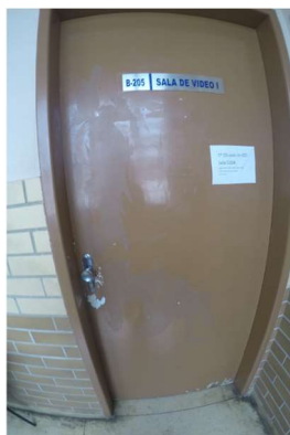
Imagem 24 - Porta sala B-205 sem sinalização em relevo, não possui maçaneta do tipo alavanca.
