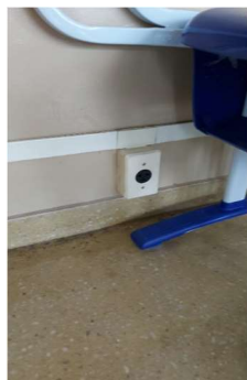
Imagem 59 - Tomada baixa localizada na sala B 106 do pavimento térreo estão a 10cm do piso, e possuem altura menor do que a mínima recomendada pela norma.
