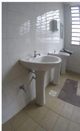
Imagem 39 - Lavatório em Sanitário Masculino coletivo térreo não está de acordo com a norma.
