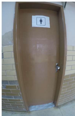
Imagem 36 - Porta Sanitário Feminino 1º pavimento sem sinalização em relevo, não possui maçaneta do tipo alavanca, vão da porta menor do que estabelecido pela norma.
