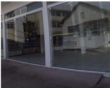
Imagem 3 - Porta de acesso a cantina não possui sinalização. Acesso possui rampa que não atende as especificações da norma, trilhos da porta dificultam o acesso de P.M.R.
