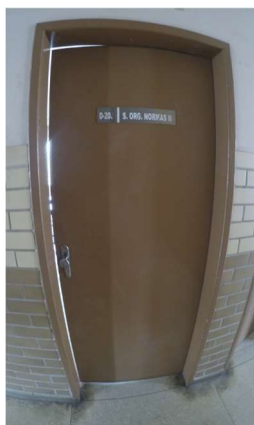
Imagem 19 - Porta Sala D 201 - sem sinalização em relevo e não possui maçaneta do tipo alavanca.
