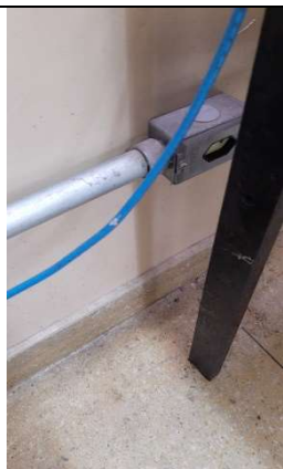
Imagem 72 - Tomada localizada na sala D-107 a 30 cm do piso, possuindo altura menor do que a recomendada pela norma.
