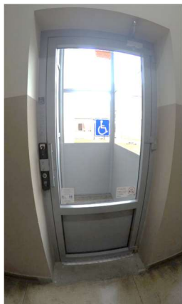
Imagem 7 - Acesso a Plataforma elevatória sem identificação de pavimento.
