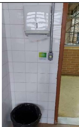
Imagem 50 - Interruptor localizado no banheiro masculino térreo está a 110cm do piso e possui altura maior do que a máxima recomendada pela norma.
