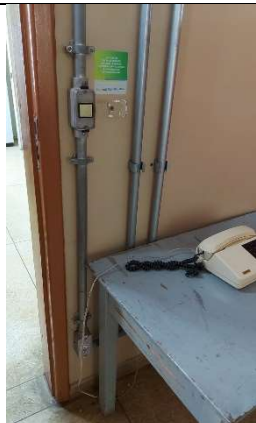
Imagem 76 - Interruptor localizado na sala D-201 a 105 cm do piso e tomada a 30 cm do piso, ambos possuem altura maior e menor, respectivamente, do que a máxima recomendada pela norma.
