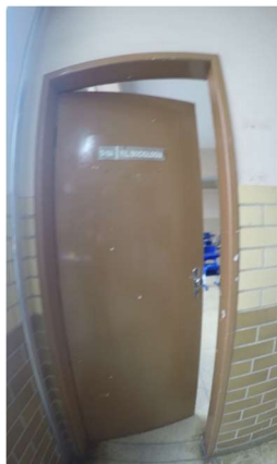
Imagem 16 - Porta D 104 - sem sinalização em relevo e não possui maçaneta do tipo alavanca.
