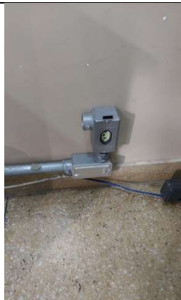
Imagem 107 - Tomada localizada na sala D-207 a 20 cm do piso, possuindo altura menor do que a recomendada pela norma.
