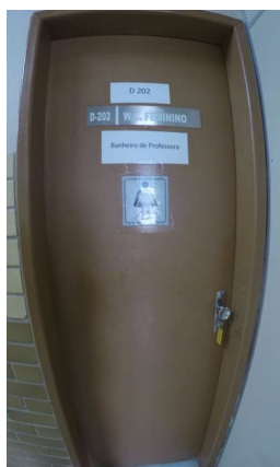
Imagem 35 - Porta Sala D 202 Sanitário Feminino 1º pavimento - sem sinalização em relevo, não possui maçaneta do tipo alavanca, vão da porta menor do que estabelecido pela norma.
