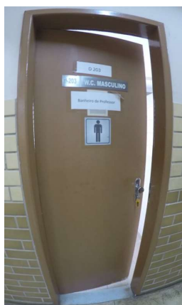
Imagem 38 - Porta D 203 – Sanitário Masculino 1º pavimento sem sinalização em relevo, não possui maçaneta do tipo alavanca, vão da porta menor do que estabelecido pela norma.
