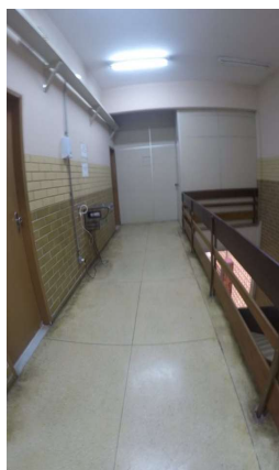
Imagem 11 - Circulação interna 1º pavimento Bloco D não possui rota acessível.
