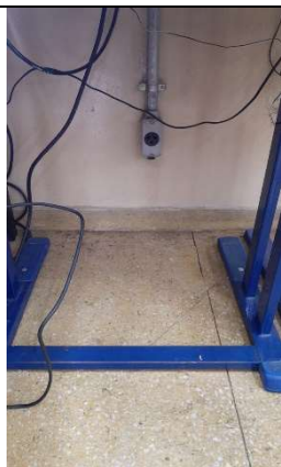
Imagem 71 - Tomada localizada na sala D-107 a 30 cm do piso, possuindo altura menor do que a recomendada pela norma.
