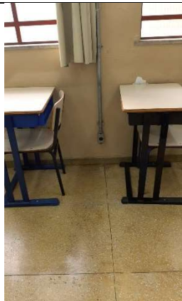
Imagem 73- Tomada localizada na sala D-107 a 30 cm do piso, possuindo altura menor do que a recomendada pela norma.
