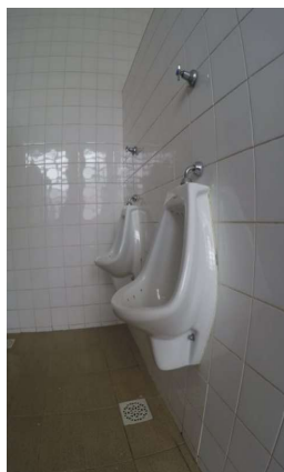
Imagem 41 - Mictório em sanitário Masculino no 1º pavimento coletivo não está de acordo com a norma.
