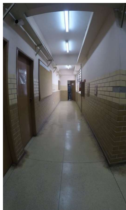
Imagem 13 - Circulação interna do 1º pavimento Bloco D não possui rota acessível.
