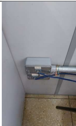
Imagem 106 - Tomada localizada na sala D-207 a 20 cm do piso, possuindo altura menor do que a recomendada pela norma.
