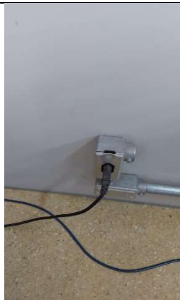
Imagem 100 - Tomada localizada na sala D-207 a 20 cm do piso, possuindo altura menor do que a recomendada pela norma.
