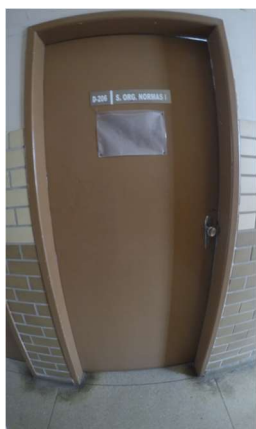
Imagem 21 - Porta Sala D 206 sem sinalização em relevo e não possui maçaneta do tipo alavanca.
