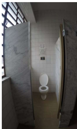
Imagem 40 - Porta do boxe em sanitário masculino no 1º pavimento abre para dentro sem ter um raio mínimo de circulação dentro dos boxes.
