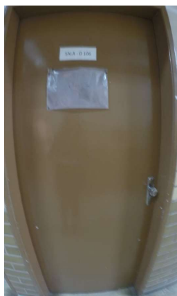
Imagem 14 - Porta D 106 - sem sinalização em relevo e não possui maçaneta do tipo alavanca.
