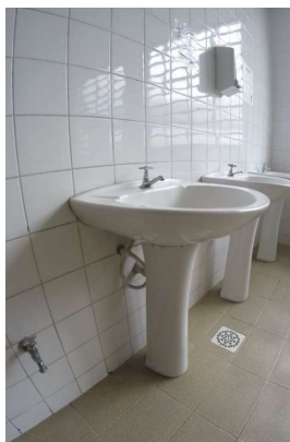
Imagem 43 - Lavatório em Sanitário Masculino coletivo no térreo não está de acordo com a norma.
