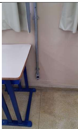
Imagem 75 - Tomada localizada na sala D-107 a 30 cm do piso, possuindo altura menor do que a recomendada pela norma.
