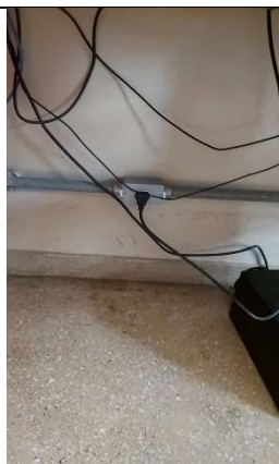
Imagem 77 - Tomada localizada na sala D-201 a 30 cm do piso, possuindo altura menor do que a recomendada pela norma.
