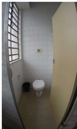
Imagem 36 - Porta do boxe em sanitário feminino do 1º pavimento abre para dentro sem ter um raio mínimo de circulação dentro dos boxes.
