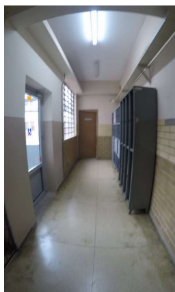
Imagem 8 - Circulação interna do térreo Bloco D - não possui rota acessível.
