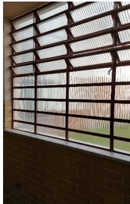
Imagem 48 - Comandos de todas as janelas da edificação estão a 180cm de altura do piso, não atendendo as recomendações da norma.
