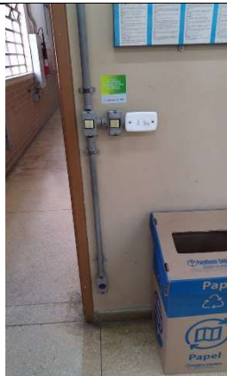
Imagem 70 - Interruptor localizado na sala D-107 a 105 cm do piso e tomada a 30 cm do piso, ambos possuem altura maior e menor, respectivamente, do que a máxima recomendada pela norma.
