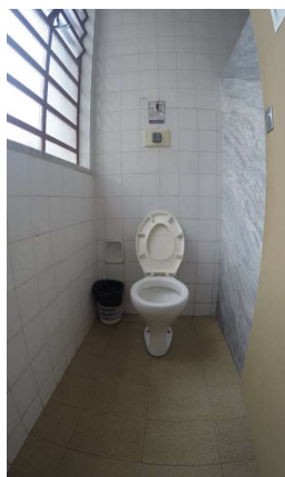
Imagem 44 - Porta do boxe em sanitário masculino no térreo abre para dentro sem ter um raio mínimo de circulação dentro dos boxes.
