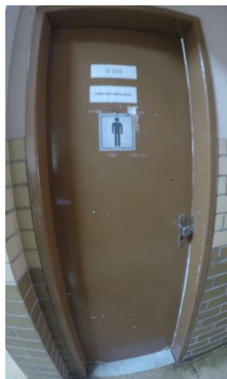
Imagem 42 - Porta Sala D 103 – Sanitário masculino no térreo, sem sinalização em relevo, não possui maçaneta do tipo alavanca, vão da porta menor do que estabelecido pela norma.
