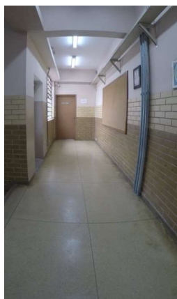
Imagem 12 - Circulação interna do 1º pavimento Bloco D não possui rota acessível.
