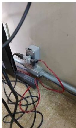
Imagem 108 - Tomada localizada na sala D-207 a 20 cm do piso, possuindo altura menor do que a recomendada pela norma.
