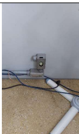
Imagem 102 - Tomada localizada na sala D-207 a 20 cm do piso, possuindo altura menor do que a recomendada pela norma.
