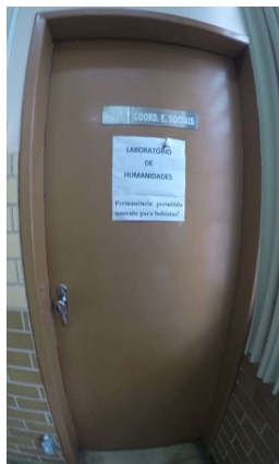
Imagem 33 - Porta Sala D 201 - sem sinalização em relevo e não possui maçaneta do tipo alavanca.
