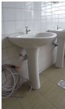
Imagem 39 - Lavatório em Sanitário Masculino do coletivo 1º pavimento não está de acordo com a norma.
