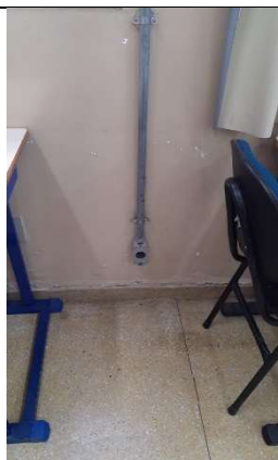
Imagem 74 - Tomada localizada na sala D-107 a 30 cm do piso, possuindo altura menor do que a recomendada pela norma.
