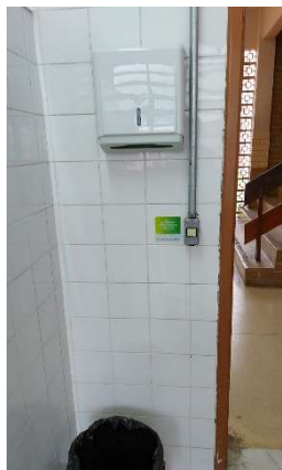
Imagem 49 - Interruptor localizado no banheiro feminino térreo está a 110cm do piso e possui altura maior do que a máxima recomendada pela norma.
