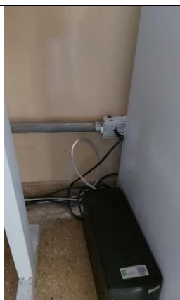
Imagem 78 - Tomada localizada na sala D-201 a 30 cm do piso, possuindo altura menor do que a recomendada pela norma.
