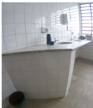
Imagem 37 – Altura da bancada do sanitário feminino no 1º pavimento possui altura maior do que a máxima permitida.
