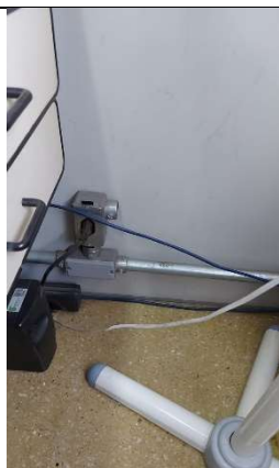
Imagem 101 - Tomada localizada na sala D-207 a 20 cm do piso, possuindo altura menor do que a recomendada pela norma.
