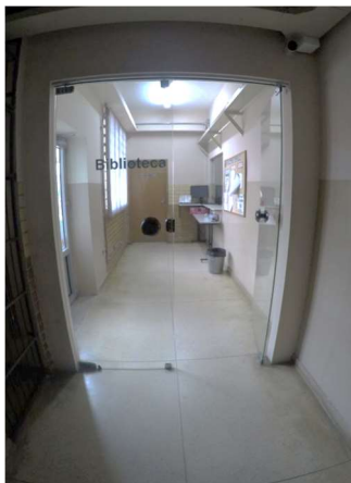
Imagem 42 – Porta de acesso ao infocentro no térreo não possui sinalização adequada, e maçaneta não é do tipo alavanca.
