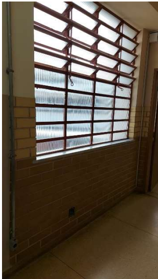
Imagem 111 - Tomada localizada na circulação do 1º pavimento, está a 25cm do piso e possui altura menor do que a mínima recomendada pela norma.
