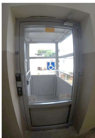
Imagem 8 - Acesso a Plataforma elevatória sem identificação de pavimento.
