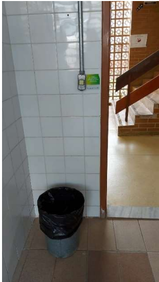
Imagem 80 - Interruptor localizada no banheiro feminino térreo, está 110cm do piso e possui altura maior do que a máxima recomendada pela norma.
