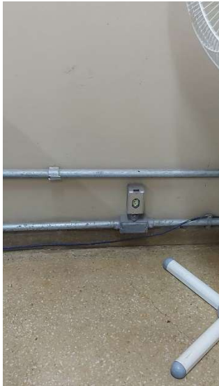
Imagem 104 - Tomada localizada na sala E206, está a 15cm do piso e possui altura menor do que a mínima recomendada pela norma.
