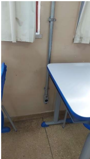
Imagem 108 - Tomada localizada na sala E207, está a 25cm do piso e possui altura menor do que a mínima recomendada pela norma.
