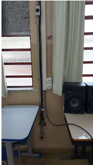
Imagem 106 - Tomadas localizada na sala E207, estão a 25 e 100cm do piso, a com altura de 25cm está menor do que a mínima recomendada pela norma.
