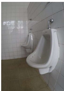
Imagem 58 - Mictório em sanitário Masculino coletivo térreo não está de acordo com a norma.
