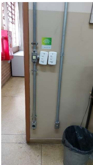
Imagem 83 - Tomadas e interruptores localizada no laboratório de línguas sala E201, as tomadas estão a 25cm do piso, estão com altura menor do que a mínima recomendada pela norma e interruptores estão a 110 cm do piso, maior do que a máxima recomendada pela norma.
