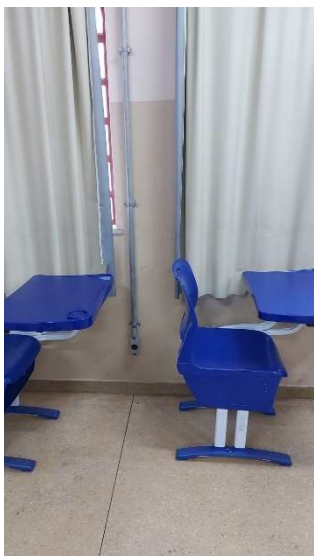
Imagem 89 - Tomada localizada na sala E204, está a 25cm do piso e possui altura menor do que a mínima recomendada pela norma.
