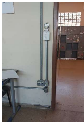
Imagem 63 – Tomadas e interruptores localizada na GETU, as tomadas estão a 40 e 50cm do piso, estão com altura mínima recomendada pela norma e interruptores estão a 137 cm do piso, maior do que a máxima recomendada pela norma.
