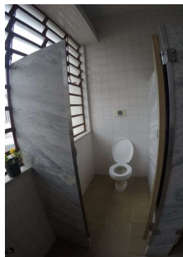
Imagem 53 - Porta do boxe em sanitário feminino 1º pavimento abre para dentro sem ter um raio mínimo de circulação dentro dos boxes.
