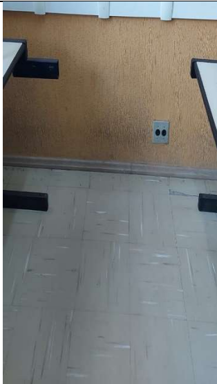
Imagem 82 - Tomadas localizada na infocentro, estão a 30cm do piso e possui altura menor do que a mínima recomendada pela norma.
