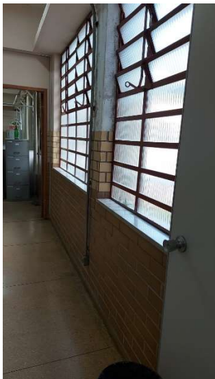
Imagem 115 - Comandos das janelas da circulação do 1º pavimento estão a 190cm de altura do piso, não atendendo as recomendações da norma.
