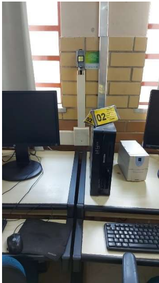
Imagem 81 - Interruptor localizada na infocentro, está 130cm do piso e possui altura maior do que a máxima recomendada pela norma.
