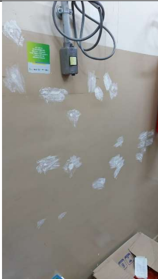
Imagem 64 - Interruptor localizada no acervo biblioteca, está 138cm do piso e possui altura maior do que a máxima recomendada pela norma
