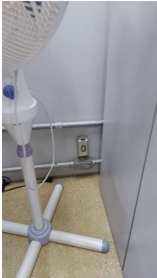
Imagem 102 - Tomada localizada na sala E206, está a 15cm do piso e possui altura menor do que a mínima recomendada pela norma.
