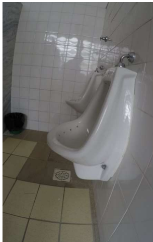
Imagem 51 - Mictório em sanitário Masculino coletivo no 1º pavimento não está de acordo com a norma.
