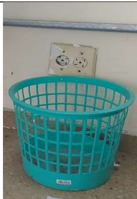
Imagem 62 - Tomadas localizada na GETU, estão a 25cm do piso e possui altura menor do que a mínima recomendada pela norma
