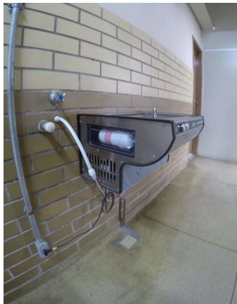
Imagem 6 - Bebedouro térreo apenas com uma altura e sem sinalização tátil de alerta.
