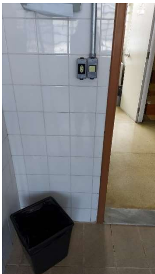
Imagem 112 - Interruptor localizada no banheiro feminino 1º pavimento, está 110cm do piso e possui altura maior do que a máxima recomendada pela norma.
