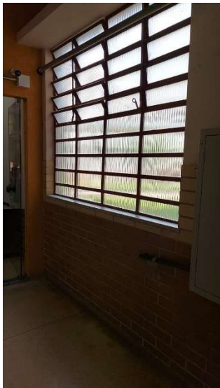
Imagem 114 - Comandos das janelas da circulação do térreo bloco E estão a 190cm de altura do piso, não atendendo as recomendações da norma.
