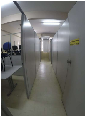
Imagem 33 - Corredor acesso salas de estudo Infocentro não possui dimensão mínima para circulação de P.C.R.
