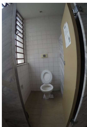
Imagem 59 - Porta do boxe em sanitário masculino térreo abre para dentro sem ter um raio mínimo de circulação dentro dos boxes.
