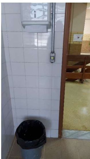
Imagem 113 - Interruptor localizada no banheiro masculino 1º pavimento, está 110cm do piso e possui altura maior do que a máxima recomendada pela norma
