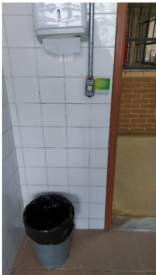
Imagem 79 - Interruptor localizada no banheiro masculino térreo, está 110cm do piso e possui altura maior do que a máxima recomendada pela norma.
