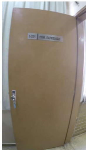
Imagem 28 - Porta Sala E 201 - sem sinalização em relevo e não possui maçaneta do tipo alavanca.
