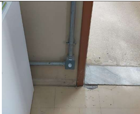
Imagem 72 - Tomada localizada na biblioteca, estão a 25cm do piso e possui altura menor do que a mínima recomendada pela norma
