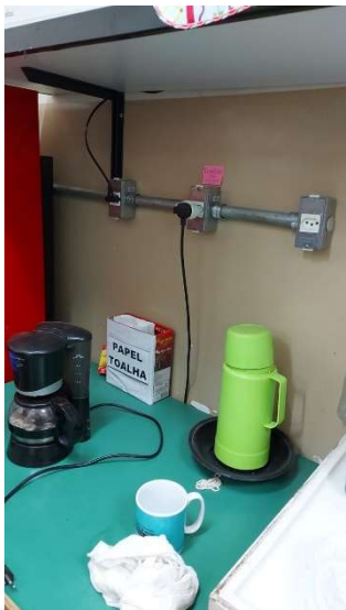
Imagem 65 - Tomadas localizada no acervo biblioteca, estão a 120cm do piso e possui altura maior do que a máxima recomendada pela norma
