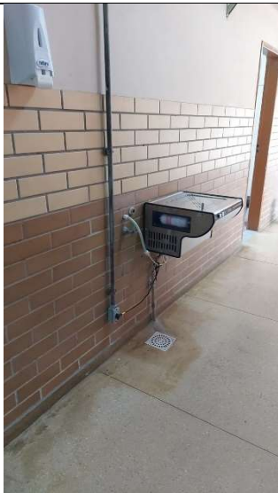
Imagem 78 - Tomada localizada na circulação térreo, está a 25cm do piso e possui altura menor do que a mínima recomendada pela norma.
