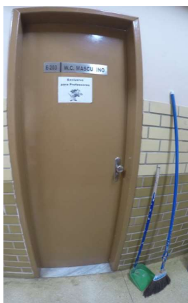
Imagem 47 - Porta sanitário masculino 1º pav sem sinalização em relevo, não possui maçaneta do tipo alavanca, vão da porta menor do que estabelecido pela norma. Não possui simbologia com desenho universal para sanitários.
