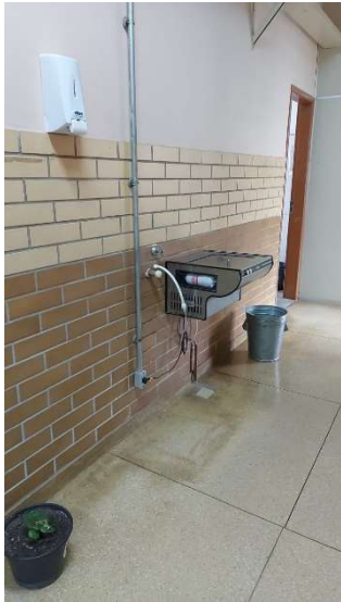
Imagem 110 - Tomada localizada na circulação do 1º pavimento, está a 25cm do piso e possui altura menor do que a mínima recomendada pela norma.
