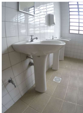
Imagem 57- Lavatório em Sanitário Masculino térreo coletivo não está de acordo com a norma.
