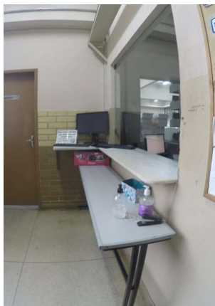
Imagem 43 – Balcão de atendimento da biblioteca não possui altura para atendimento á P.M.R e a P.C.R.
