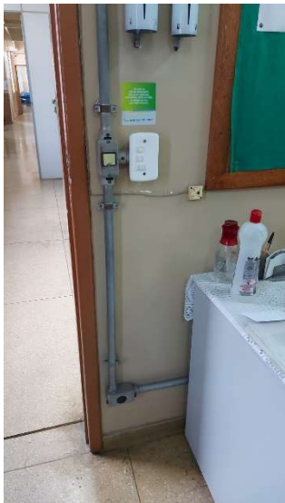
Imagem 94 - Tomada e interruptores localizada na sala E206, a tomada está a 25cm do piso, está com altura menor do que a mínima recomendada pela norma e interruptores estão a 105cm do piso, maior do que a máxima recomendada pela norma.
