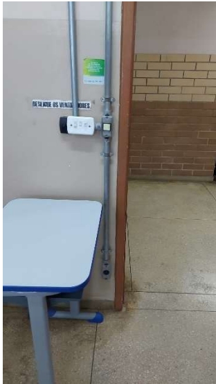
Imagem 90 - Tomada e interruptores localizada na sala E205, a tomada está a 25cm do piso, estão com altura menor do que a mínima recomendada pela norma e interruptores estão a 110cm do piso, maior do que a máxima recomendada pela norma.
