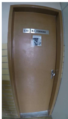
Imagem 52 - Porta sanitário feminino 1º pavimento sem sinalização em relevo, não possui maçaneta do tipo alavanca, vão da porta menor do que estabelecido pela norma. Não possui simbologia com desenho universal para sanitários.
