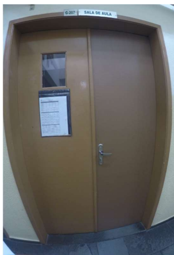
Imagem 39 - Porta G 207 sem sinalização em relevo
