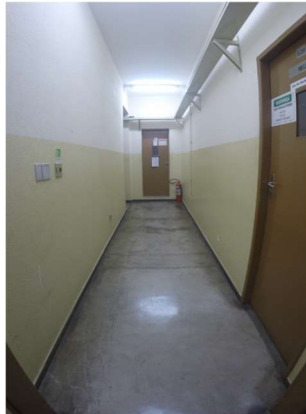
Imagem 24 - Circulação interna 1º pavimento não possui rota acessível.
