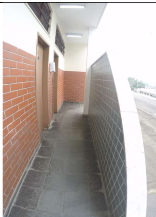
Imagem 2 - Acesso aos Sanitários coletivos do pavimento térreo no bloco G não possuem sinalização e espaço para manobra de P.C.R.
