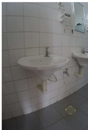
Imagem 4 - Lavatório em Sanitário Feminino coletivo térreo não está de acordo com a norma.
