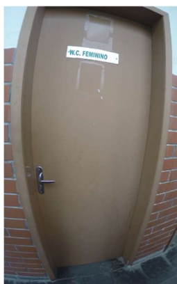
Imagem 3 - Porta sanitário feminino pavimento térreo sem sinalização em relevo, vão da porta menor do que estabelecido pela norma. Porta não possui simbologia para sanitário.
