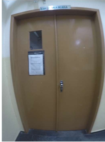
Imagem 37 - Porta G 206 - sem sinalização em relevo, não possui maçaneta do tipo alavanca.
