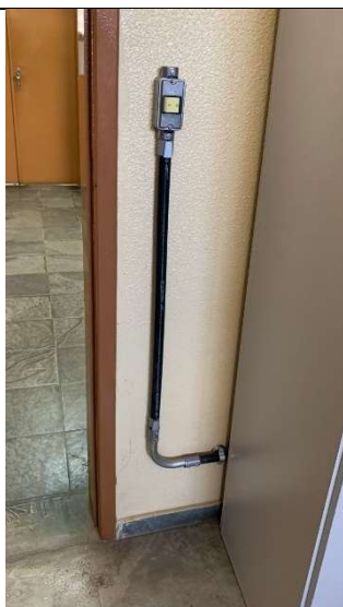
Imagem 94 - - interruptor localizados na copa estão a 120 cm do piso e possuem altura superior a máxima recomendada pela norma
