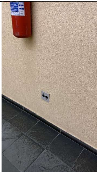
Imagem 93 - tomadas localizados na circulação do 1º pavimento estão a 35 cm do piso e possuem altura inferior a mínima recomendada pela norma
