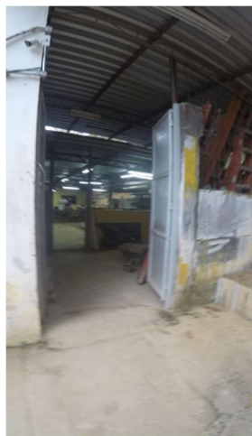
Imagem 5 - Acesso a oficina sem sinalização.
