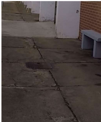
Imagem 3 – Piso externo do Ginásio não possui superfície regular e causa instabilidade, dificultando a circulação de pessoas com mobilidade reduzida.
