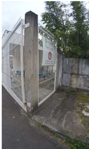
Imagem 6 – Acesso ao Campus não possui piso instável e não está sinalizado corretamente.
