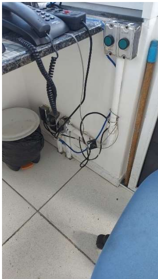
Imagem 14 – botoeiras e tomadas estão a 90cm e 30cm do piso, botoeiras possuem altura de acordo com a norma e tomadas estão em altura inferior à norma
