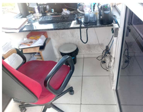
Imagem 4 – Espaço interno não possui dimensionamento para circulação e manobra de P.C.R.
