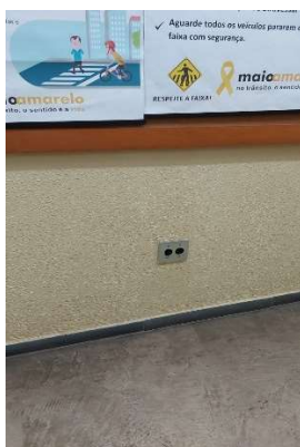
Imagem 43 – Tomadas baixas localizadas na circulação de acesso a sala 202 estão 40cm do piso e possui altura menor do que a mínima recomendada pela norma.
