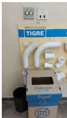
Imagem 80 - Interruptores localizados na sala H-206 (Hidráulica) e estão a 130cm do piso e possui altura maior do que a recomendada pela norma sendo uma altura padrão para todo o bloco.
