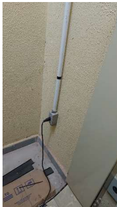
Imagem 56 - Tomada baixa localizada na sala Telemática e está a 30 cm do piso e possui altura menor do que a recomendada pela norma.
