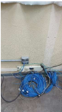
Imagem 66 - Tomada baixa localizada na sala H-201 (LICC) está a 30 cm do piso e possui altura menor do que a recomendada pela norma
