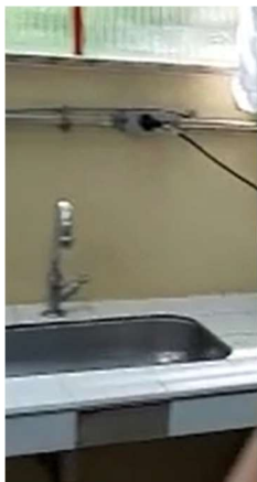
Imagem 88 - Tomadas médias localizadas na sala de bolsistas e estão a 150 cm do piso e possui altura superior a recomendada pela norma.
