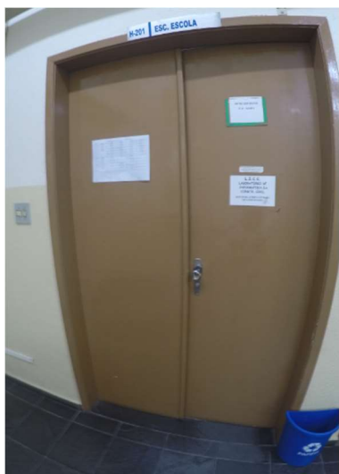
Imagem 31 - Porta H 201 sem sinalização em relevo, não possui maçaneta do tipo alavanca.
