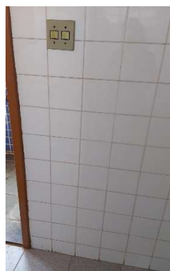
Imagem 58 - Interruptores localizados no banheiro feminino do térreo e estão a 130cm do piso e possui altura maior do que a recomendada pela norma sendo uma altura padrão para todo o bloco
