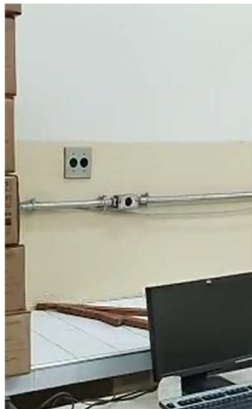
Imagem 87 - Tomadas médias localizadas na sala de bolsistas e estão a 150 cm do piso e possui altura superior a recomendada pela norma.
