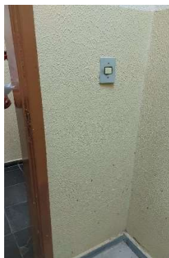
Imagem 57 - Interruptor localizado na sala Telemática e está a 130cm do piso e possui altura maior do que a recomendada pela norma sendo uma altura padrão para todo o bloco
