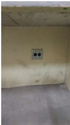
Imagem 54 - Tomada baixa localizada na sala H-103 está a 30 cm do piso e possui altura menor do que a recomendada pela norma.
