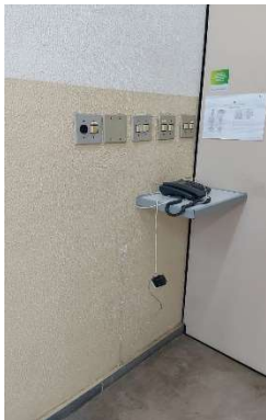
Imagem 48 - Interruptores localizados na sala H-105 estão a 130cm do piso e possui altura maior do que a máxima recomendada pela norma, sendo uma altura padrão para todo bloco
