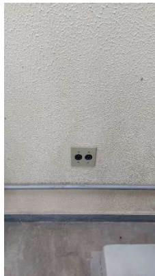
Imagem 55 - Tomada baixa localizada na sala H-103 está a 30 cm do piso e possui altura menor do que a recomendada pela norma.
