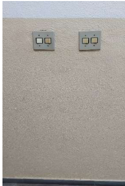
Imagem 42- Interruptores localizados na circulação de acesso a sala 202 estão a 130cm do piso e possui altura maior do que a máxima recomendada pela norma
