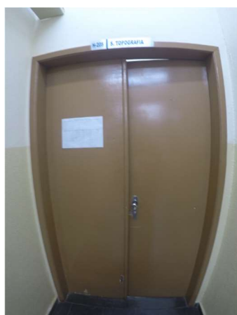
Imagem 32 - Porta H 205 sem sinalização em relevo, não possui maçaneta do tipo alavanca.
