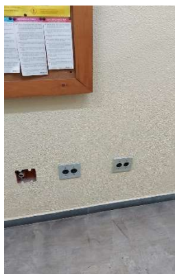
Imagem 44- Tomadas baixas localizadas na circulação de acesso a sala 202 estão 40cm do piso e possui altura menor do que a mínima recomendada pela norma.
