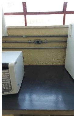
Imagem 49 - Tomada média localizada na sala H-106 está a 130 cm do piso e possui altura maior do que a máxima recomendada pela norma.
