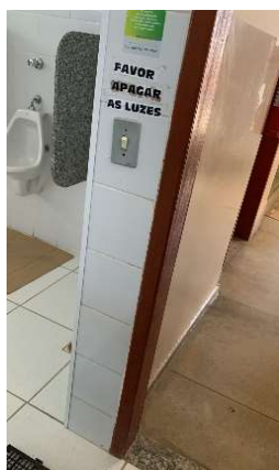
Imagem 24 - Interruptor localizado no banheiro masculino e se encontra a 110 cm do piso e possuindo altura maior do que a recomendada pela norma.
