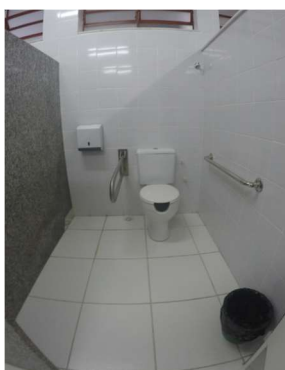
Imagem 14 – Sanitário em vestiário masculino sem dispositivo de alarme de emergência, barra de apoio com altura e posicionamento incorreto. Vaso sanitário não pode ter abertura frontal.
