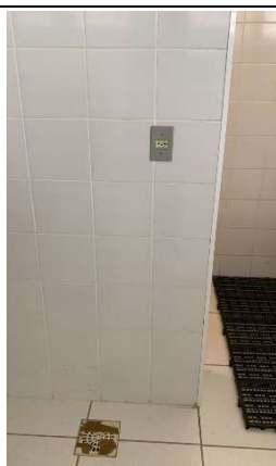
Imagem 25 - Interruptor localizado no banheiro masculino e se encontra a 110 cm do piso e possuindo altura maior do que a recomendada pela norma.
