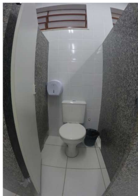
Imagem 12 - Portas dos boxes em vestiário masculino abrem para dentro sem ter um raio mínimo de circulação dentro dos boxes.
