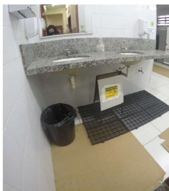
Imagem 10 – Acesso ao Vestiário masculino não tem espaço para manobra de P.C.R.
