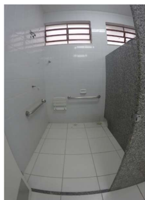
Imagem 13 – Barras de apoio em box acessível masculino não estão posicionadas e dimensionadas corretamente, banco não dimensionado corretamente, comando do chuveiro não possui válvula termostática.
