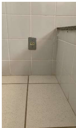
Imagem 23 - Tomadas baixas localizadas no banheiro feminino estando a 30 cm do piso e possuindo altura menor do que a recomendada pela norma.
