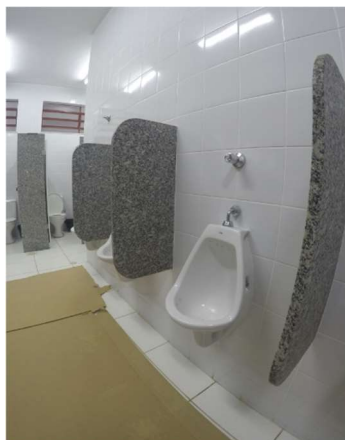
Imagem 11 - Vestiário Masculino coletivo não possui sanitário acessível.
