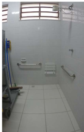
Imagem 15 - Barras de apoio em box em vestiário feminino não estão posicionadas e dimensionadas corretamente, banco não dimensionado corretamente, comando do chuveiro não possui válvula termostática.
