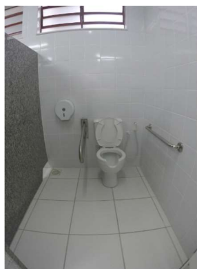
Imagem 16 – Box acessível em vestiário feminino sem dispositivo de alarme de emergência, barra de apoio com altura e posicionamento incorreto. Vaso sanitário não pode ter abertura frontal.
