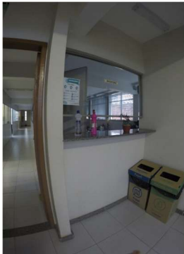
Imagem 10 – Balcão de atendimento possui altura maior do que a máxima permitida.
