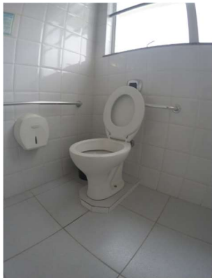
Imagem 12 – Bacia sanitária em sanitário acessível não possui altura correta. Barras de apoio também não estão na altura correta permitida e não possui barra na posição vertical.
