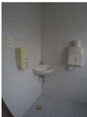
Imagem 13 – Lavatório em sanitário acessível não possui barras de apoio.
