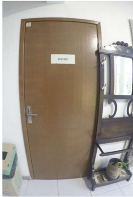
Imagem 11 – Porta de acesso a sanitário destinado a P.C.R não possui sinalização visual com símbolo internacional de acesso. Não possui sinalização com texto em relevo.
