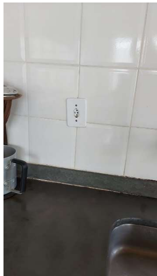
Imagem 47 - tomada localizada na cozinha, está com uma altura de 120cm do piso e possui altura maior do que a máxima recomendada pela norma.
