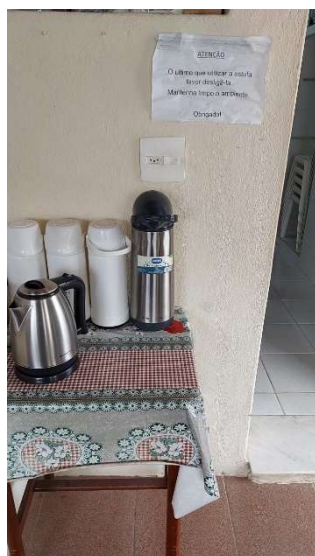
Imagem 48 - Interruptor e tomada localizada na cozinha, o interruptor e tomada estão com uma altura de 120cm do piso e possui altura maior do que a máxima recomendada pela norma.
