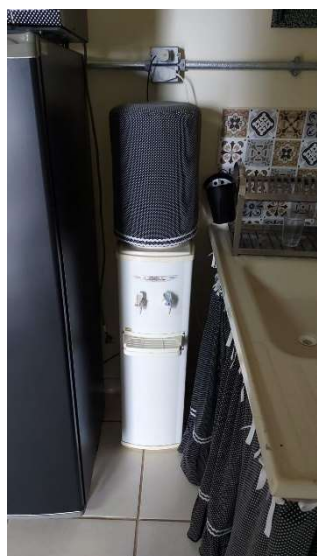
Imagem 76 - tomada localizada na copa, está com uma altura de 135cm do piso e possui altura maior do que a máxima recomendada pela norma.
