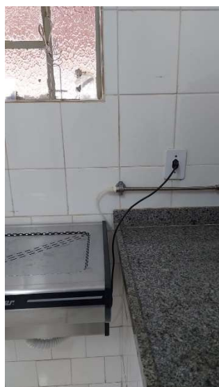
Imagem 42 - tomada localizada na cozinha, está com uma altura de 120cm do piso e possui altura maior do que a máxima recomendada pela norma.
