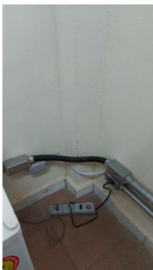
Imagem 38 - Tomada localizada na auditoria, está a 25cm do piso e possui altura menor do que a mínima recomendada pela norma.
