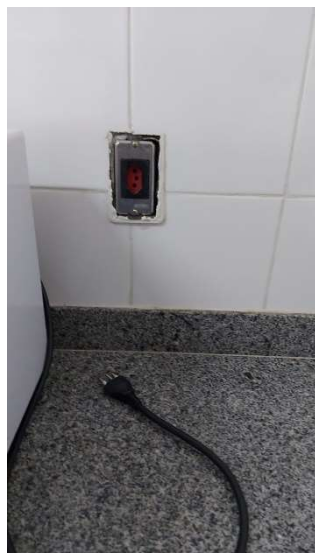
Imagem 41 - tomada localizada na cozinha, está com uma altura de 120cm do piso e possui altura maior do que a máxima recomendada pela norma.
