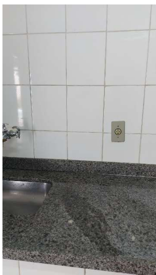
Imagem 44 - tomada localizada na cozinha, está com uma altura de 120cm do piso e possui altura maior do que a máxima recomendada pela norma.
