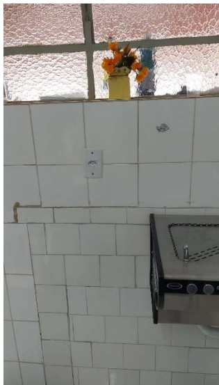
Imagem 43 - tomada localizada na cozinha, está com uma altura de 120cm do piso e possui altura maior do que a máxima recomendada pela norma.
