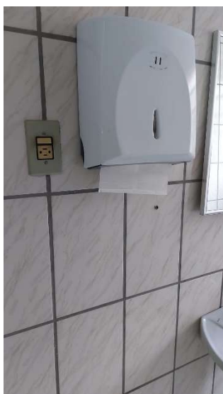
Imagem 56 - Interruptor e tomada localizada no banheiro feminino, o interruptor e tomada estão com uma altura de 125cm do piso e possui altura maior do que a máxima recomendada pela norma.
