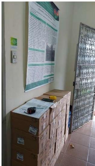
Imagem 55 - Interruptor localizada na circulação, está com uma altura de 130cm do piso e possui altura maior do que a máxima recomendada pela norma.
