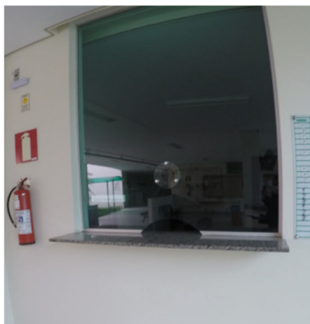
Imagem 90 - Atendimento setor pedagógico possui balcão com altura maior no que a máxima permitida.
