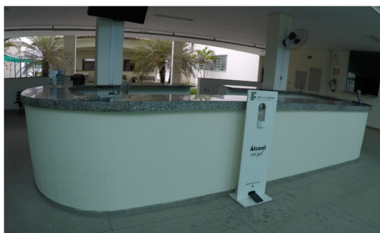
Imagem 88 – Balcão de atendimento e informação não possui altura e afastamento frontal para atendimento a P.C.R..
