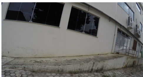
Imagem 14 – Rampa de acesso a sala de aula para deslocamento de materiais deve possuir guarda corpo.
