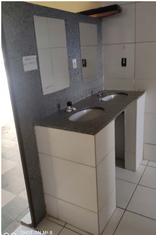
FOTO 1: Pias do banheiro não acessíveis.
